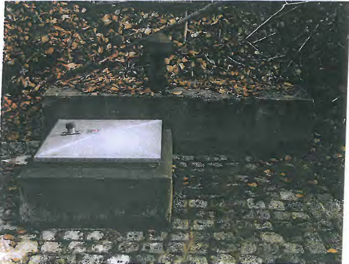
Photo 35: Partie de l'important dispositif de captage d'eau potable dans la RFI Schnellert
